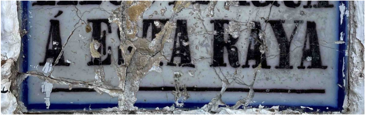
Entre las alteraciones observadas destacaban numerosas fisuras y fracturas que afectaban tanto al soporte cerámico como a la capa vítrea.
